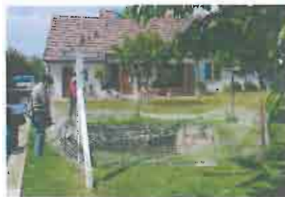
Figure 6 : effondrement dans un jardin en Loir-et-Cher (CEREMA)
