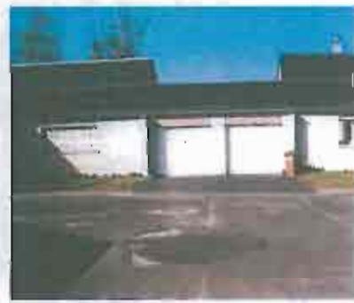
Figure 21 : fontis rebouché rue des Bazannes
