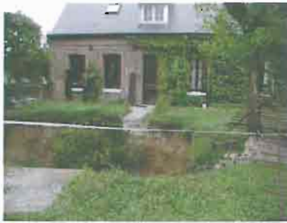
Figure 8 : effondrement du chemin d'accès d'une maison individuelle (georisques.gouv.fr)
