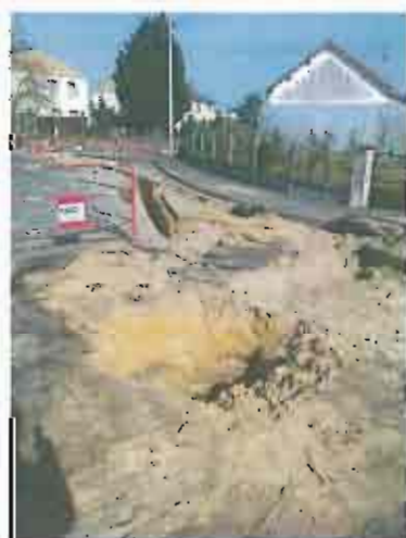
Figure 24 : vue du fontis survenu en mars 2013 lors de travaux de VRD - avenue de Langen
