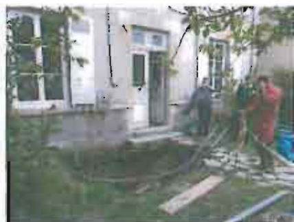
Figure 2 : Effondrement survenu sous une semelle composée de moellons. La fondation assure le maintien de l'habitation en sollicitant sa résistance en traction
