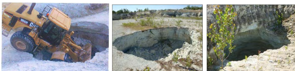
Figure 47 : Evènement historique du 23/09/2011 et effondrements au sein de la carrière en juin 2012 (désordre n° 1 sur la photo de gauche et désordre n° 6 sur celle de droite localisés ci-dessous) (Sources : BRGM et Mme Pochon)
