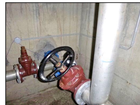
Conduite de distribution
