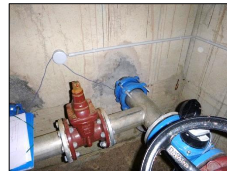
Conduite de distribution
