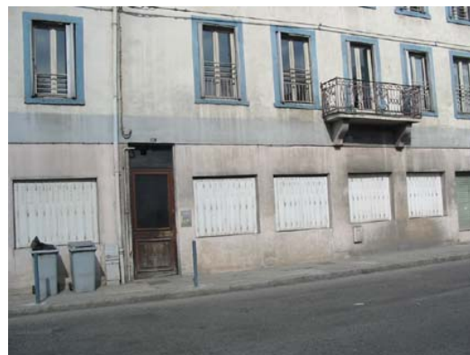
Eviter : la perte du caractère de ce rez de chaussée transformé.
