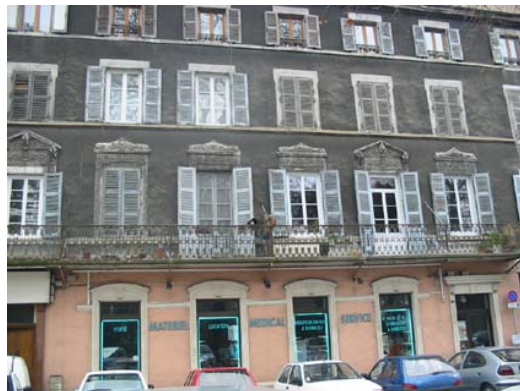
Composition d'origine en place, mais les teintes du rez de chaussée ne sont pas en accord avec la façade. Bd Asiaticus
