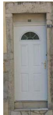
Eviter : la porte de style anglo saxon, l'ouverture XVII e s réduite en hauteur pour placer la porte !
