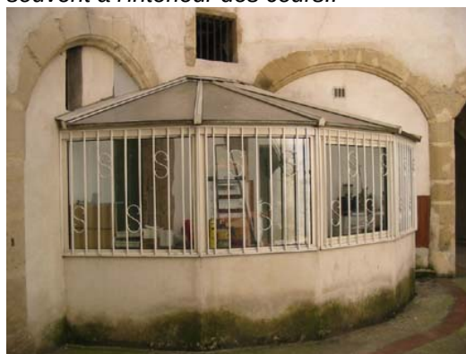
Eviter : l'empiètement sur le vide des cours contribue aussi à l'asphyxie du bâti ancien.
