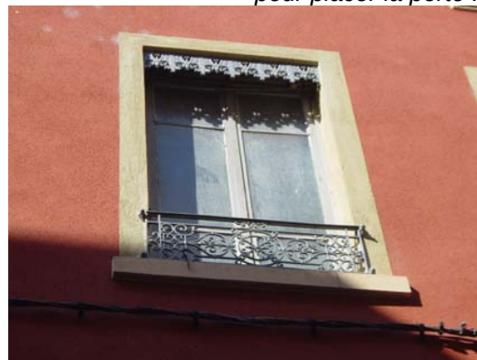
Châssis à trois carreaux, lambrequin pour cacher le store, garde corps en fonte moulée. Le vitrage plein jour banaliserait la façade.
