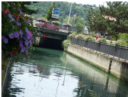
Canalisation et passage en souterrain de la Sévenne
