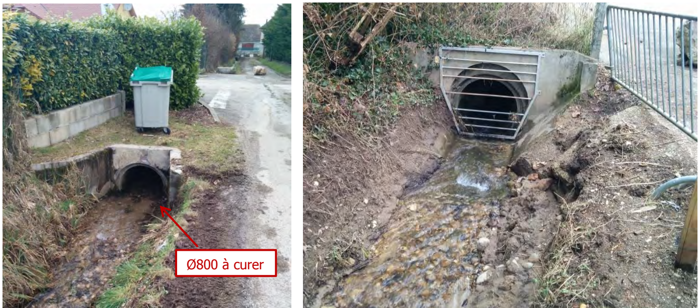
Figure 20. Buse sous la Rue du Perrier (gauche) et entrée de la buse sous la RD 1075 (droite)
