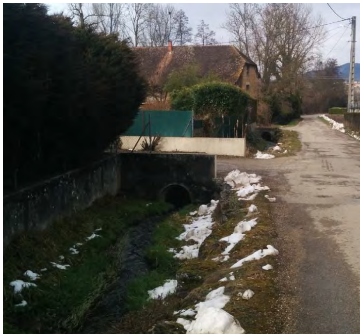
Figure 16. Buse Ø650 à remplacer par un dalot 1600*800 mm
