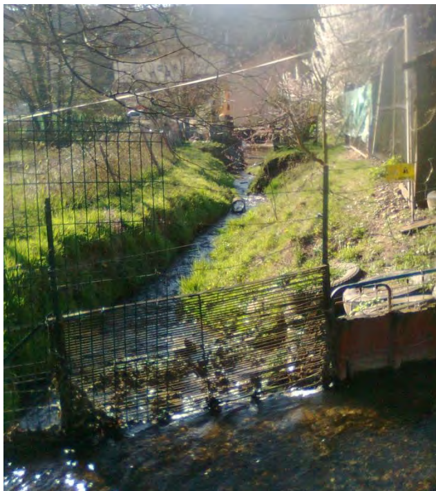
Figure 8. Ouvrage de régulation à la limite de deux bras du ruisseau des Moulins
