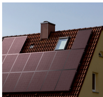
Exemple d'intégration de panneaux photovoltaïques à la toiture
