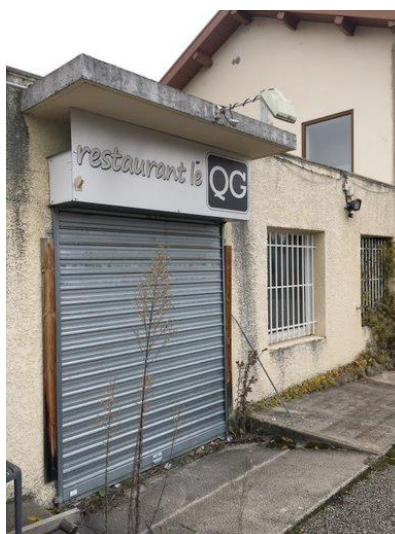
Restaurant – Enseigne alors que l'activité a cessé – Non conforme.
