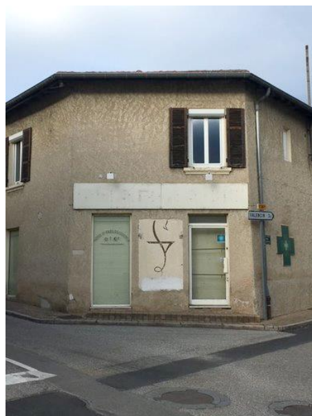
Local commercial vacant - Ordonnancement de façade respecté - Décors en façade et vitrophanie. Support d'enseigne en applique (bandeau) – Enseigne alors que l'activité a cessé – Non conforme.
