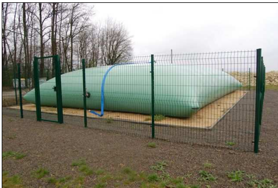
Photo d'une réserve incendie souple
