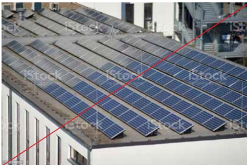
Panneaux photovoltaïques sur toiture plate - A ÉVITER
