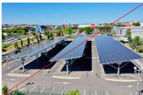
Ombrières sur zone de stationnement - A EVITER
