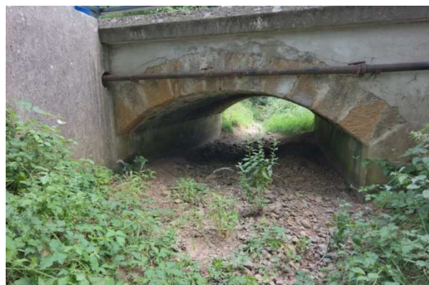
Ponceau de la Petite Derroy engravé
