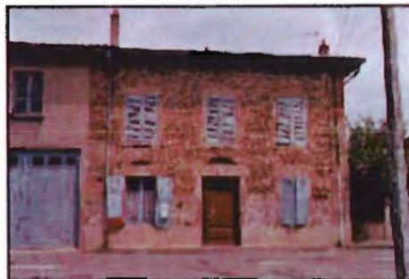
Maison villageoise en galets roulés, avec ajouts de briques et de pierre de taille.
