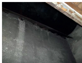
Photo 20 : Cuve aérienne dans le bâtiment F
