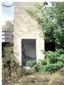
Photo 19 : Local transformateur électrique
