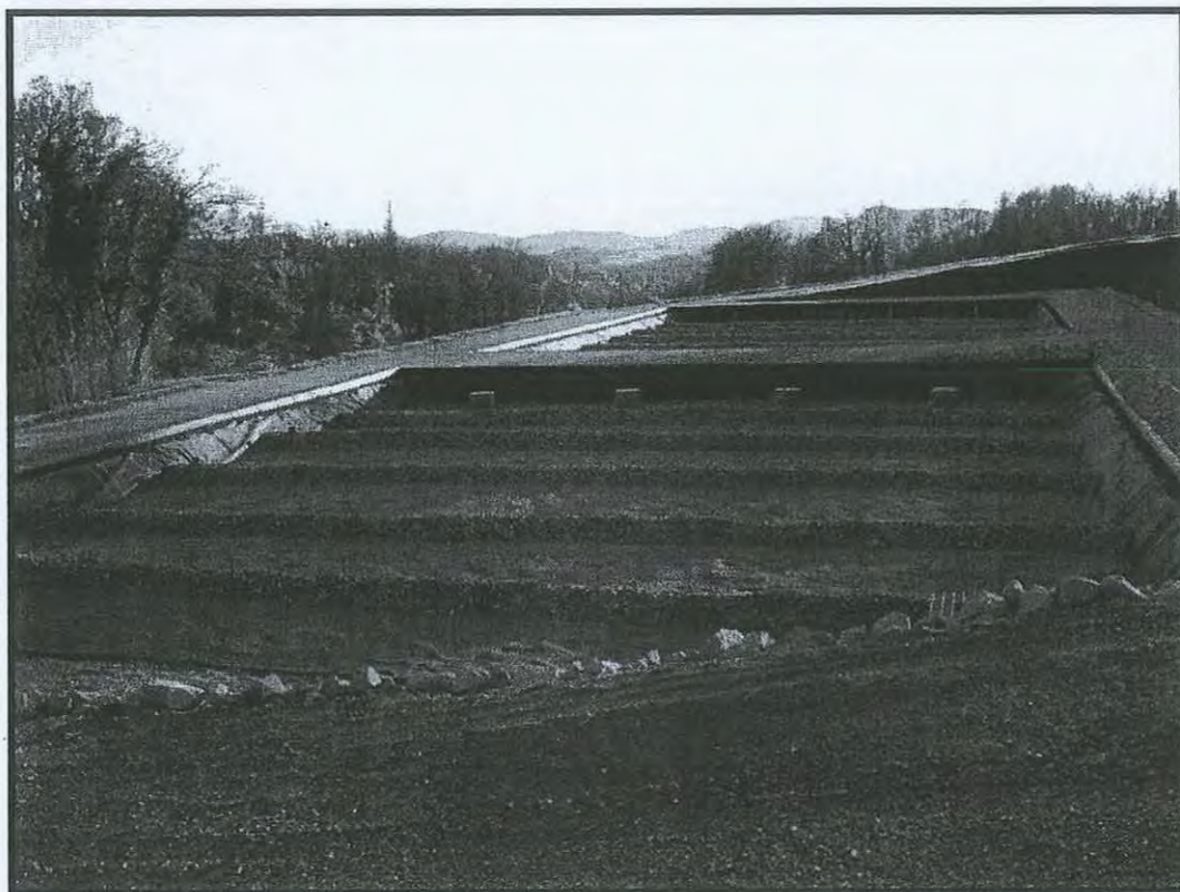
L'étage inférieur de la station
