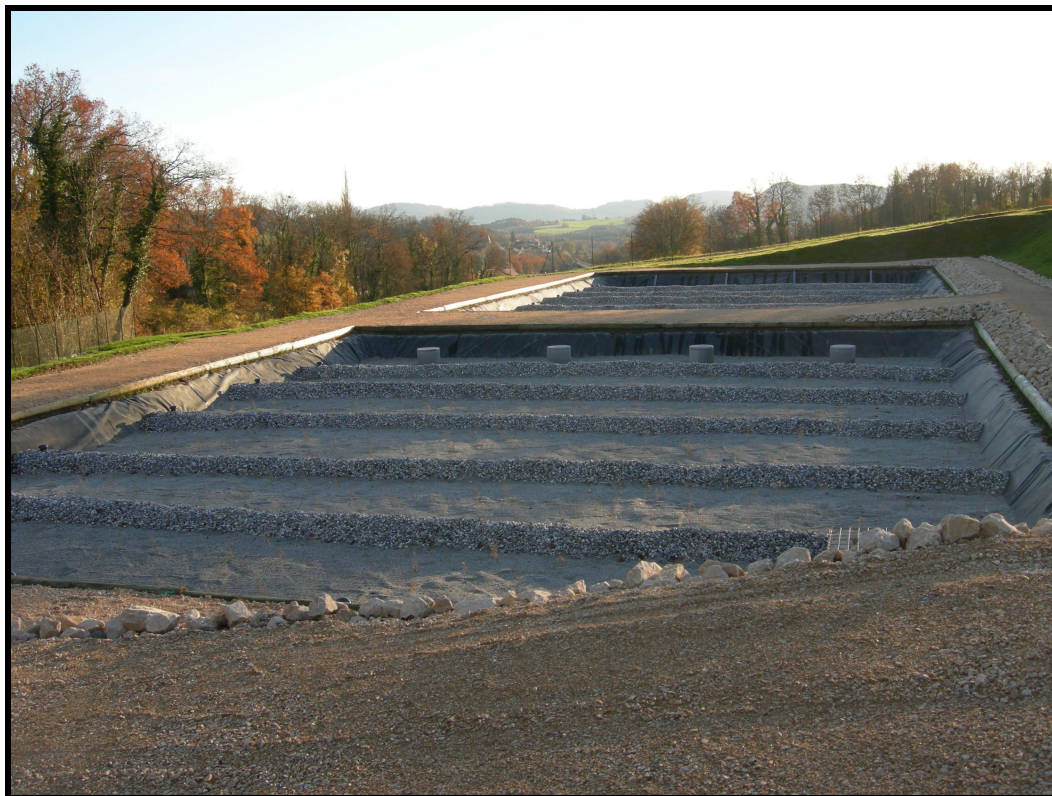
L'étage inférieur de la station
