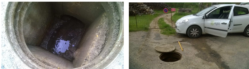
Rejet d'eau usée dans un réseau pluvial
