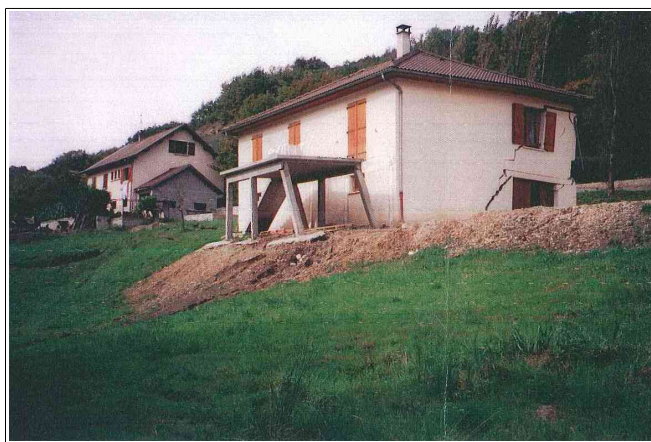
Une maison située à l'aval de la RD56 a été fortement endommagée. Elle a dû être démolie. On notera les fissures sur ses façades et le décollement de la terrasse de la façade aval. On remarquera également la faible pente du terrain.
