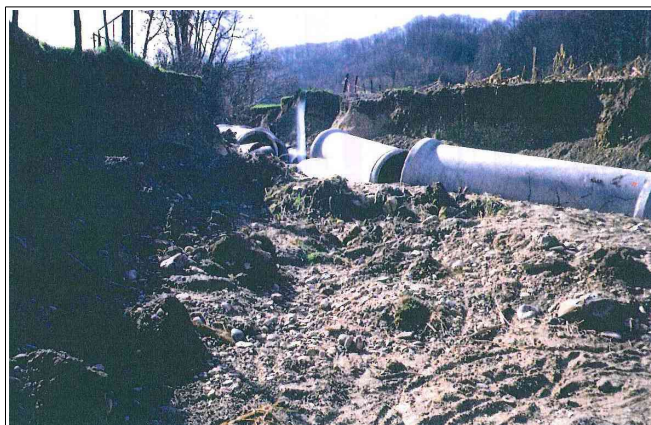
Ravinement occasionné par le ruisseau des EYNARDS en octobre 1993 au débouché de sa combe.
