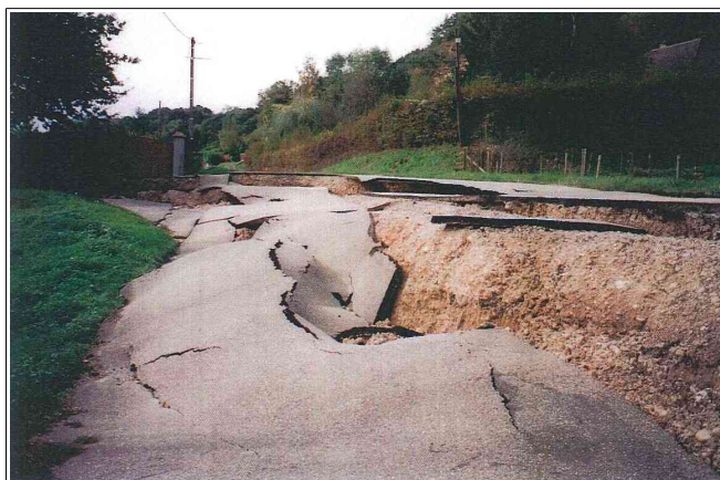
RD56 détruite par le glissement de terrain d'octobre 1993.
