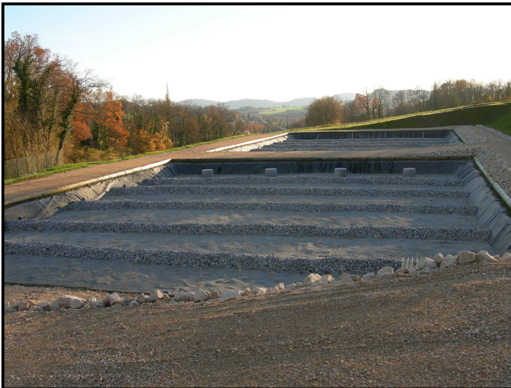
L'étage inférieur de la station
