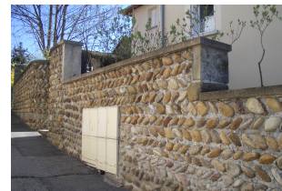
Intégration des coffrets techniques
