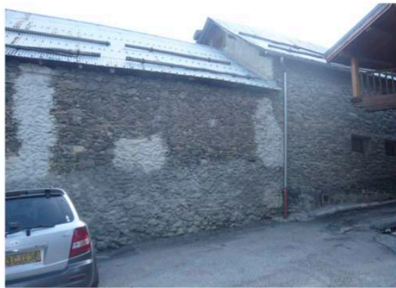
Le ciment sur ce mur en pierre est garant de désordre dans le mur à terme, car il maintient l'humidité et accélère la dégradation des pierres.
