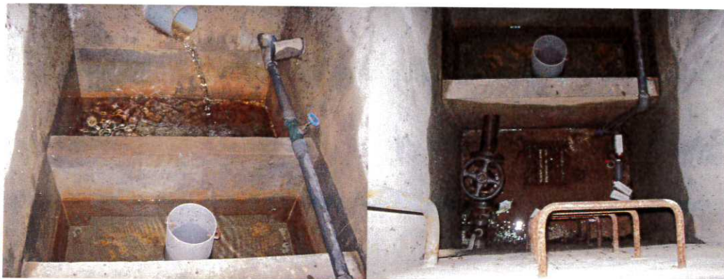
Figure 7 : Intérieur de la chambre de captage : -photo de gauche : arrivées d'eau du massif drainant (à gauche) et du captage de Ruelle (paroi de droite) -photo de droite : départ vers le réservoir de Cholonge et trop-plein
