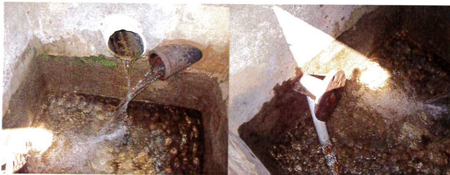
Figure 5 : Intérieur de la chambre de captage : -photo de gauche : arrivées d'eau des drains A et B -photo de droite : départ vers le captage de Claudi et trop-plein
