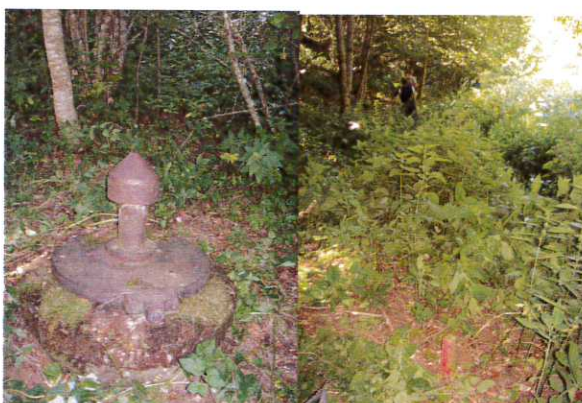
Figure 12 : Captage de La Coirelle et piquets matérialisant l'extrémité des drains
