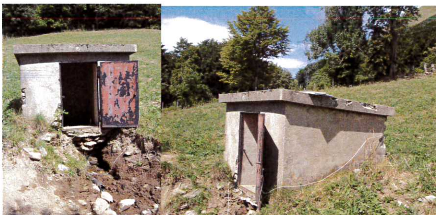
Figure 3 : Chambre de captage de Ruelle
