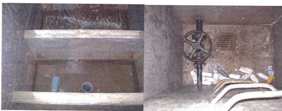
Figure 10 : Intérieur de la chambre de captage : -photo de gauche : arrivées d'eau du massif drainant (au fond) crépine de l'adduction et bonde de trop-plein (au centre) -photo de droite : départ vers le réservoir de Bergogne et Josserands
