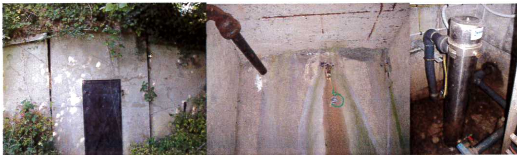
Figure 22 : Vue du réservoir de Cholonge (extérieur, intérieur) et du dispositif de traitement UV
