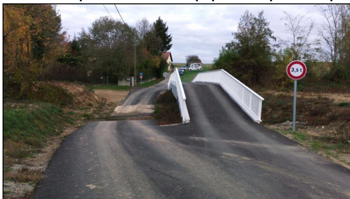
Pont communal du Suzon sujet à de légères mises en charge
