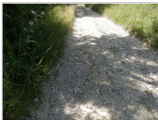
Figure n°20: Traces de ravinement sur le chemin de la « Combe Vieille »
