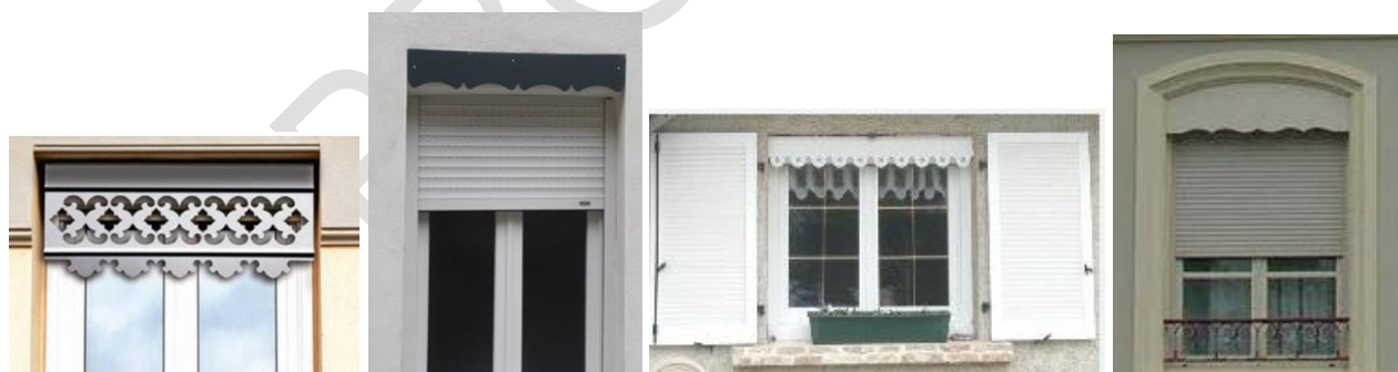
Exemple de dispositifs d'habillage des coffrets
