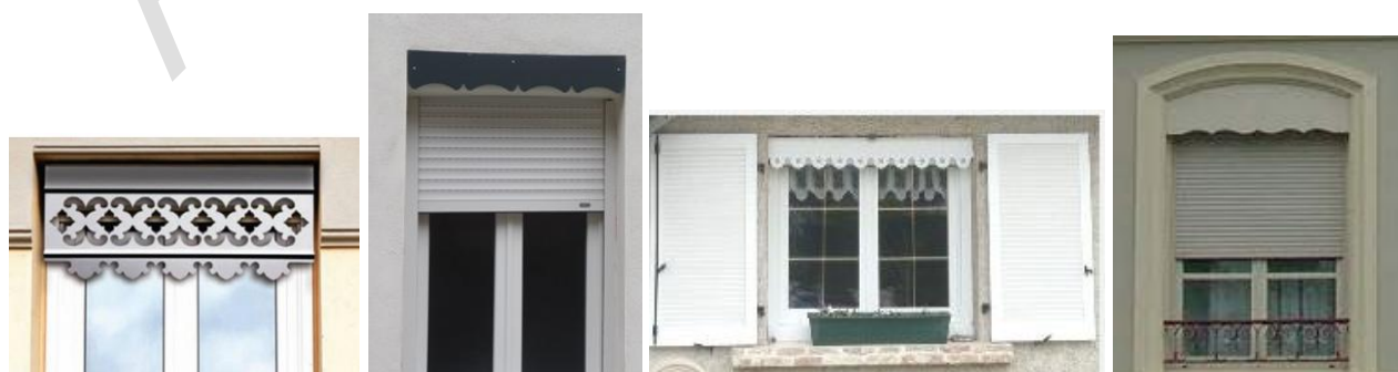
Exemple de dispositifs d'habillage des coffrets
