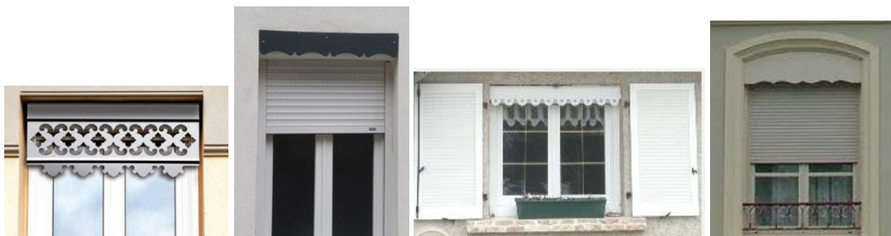
Exemple de dispositifs d'habillage des coffrets
