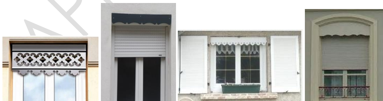
Exemple de dispositifs d'habillage des coffrets
