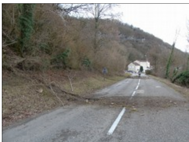
Photo 15 : Impacts sur la RD65 lors de l'évènement du 31 janvier 2017.
