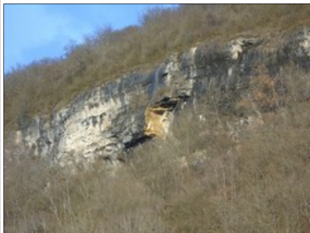
Photo 14 : Zone de départ des blocs de l'évènement du 31 janvier 2017.
