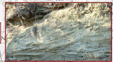
Traces de chutes de quelques blocs décimétriques et lieu d'un ancien écoulement
