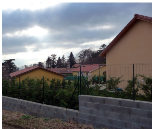
Les murs en moellons qui restent longtemps non enduits finissent par altérer le paysage.
