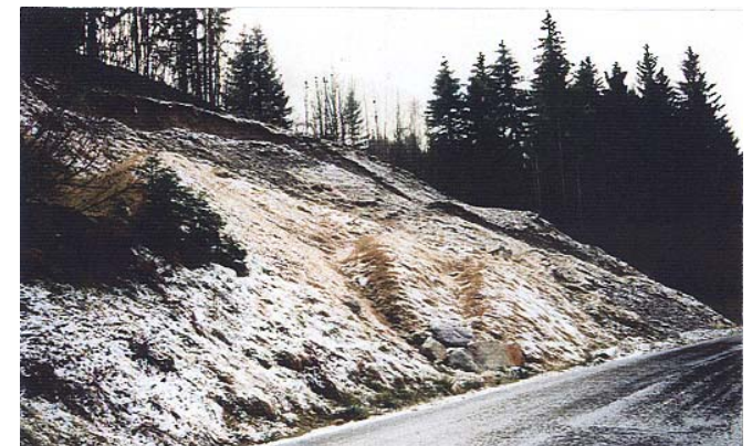
Glissement de terrain sur la route de Super Collet (G3 sur la Carte des Aléas)
