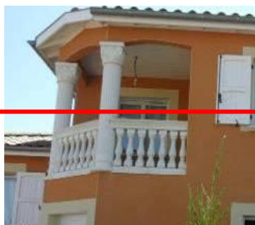
Type de balustres interdits
