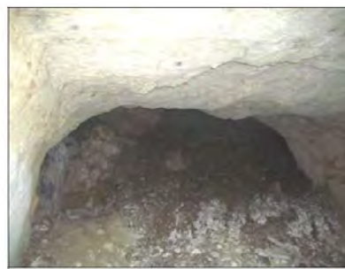
Galerie effondrée - carrière des Bouvrières
