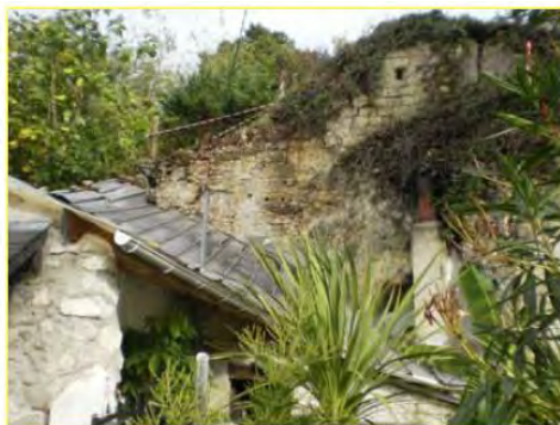
Mur fragile rue Descartes, avant les travaux de confortement du coteau en 2010
