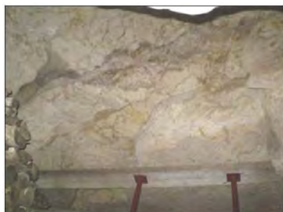
Voûte fragile - cave rue Descartes
