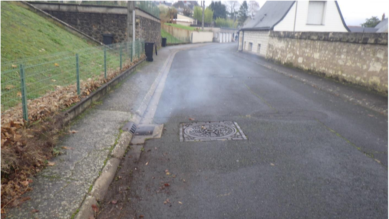
Figure 28 : photographie de l'anomalie de raccordement en domaine public
