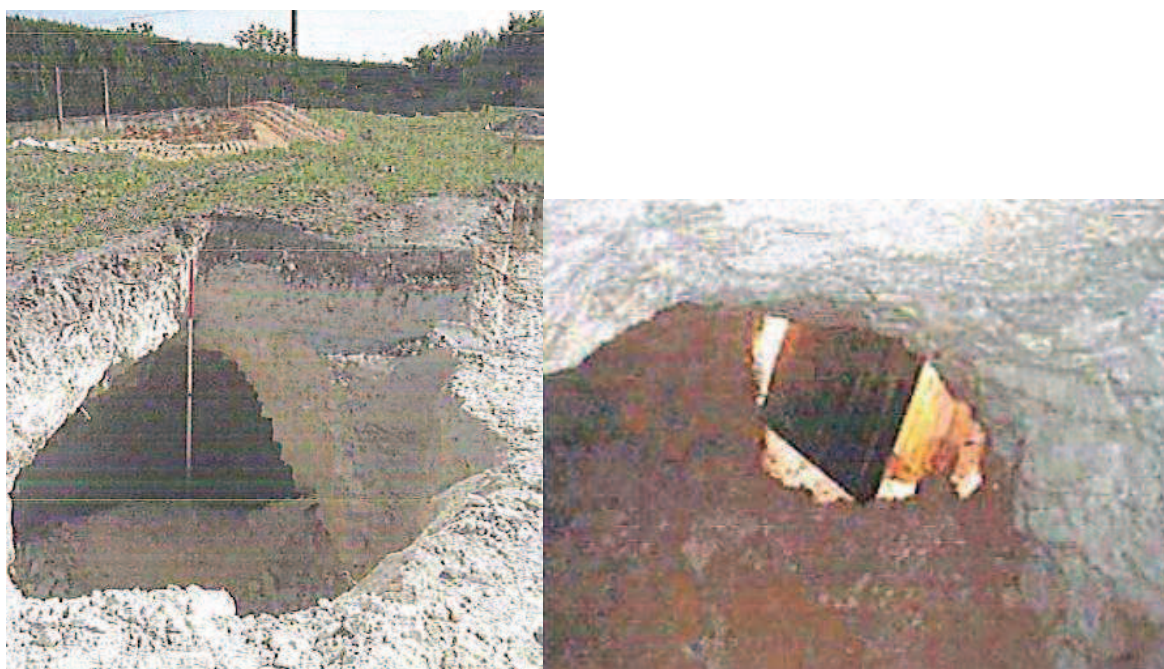
Figure 10 : exemples de cavités souterraines oubliées découvertes en cours de travaux
