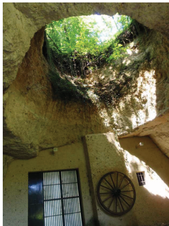
Figure 12 : vue sur un fontis dans le secteur des caves Saint Martin
