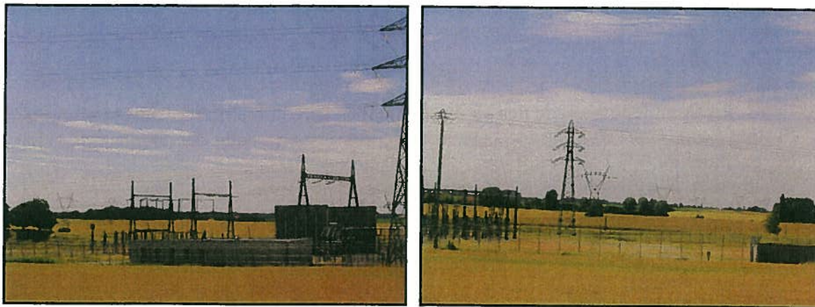
Poste de répartition de l'énergie électrique
