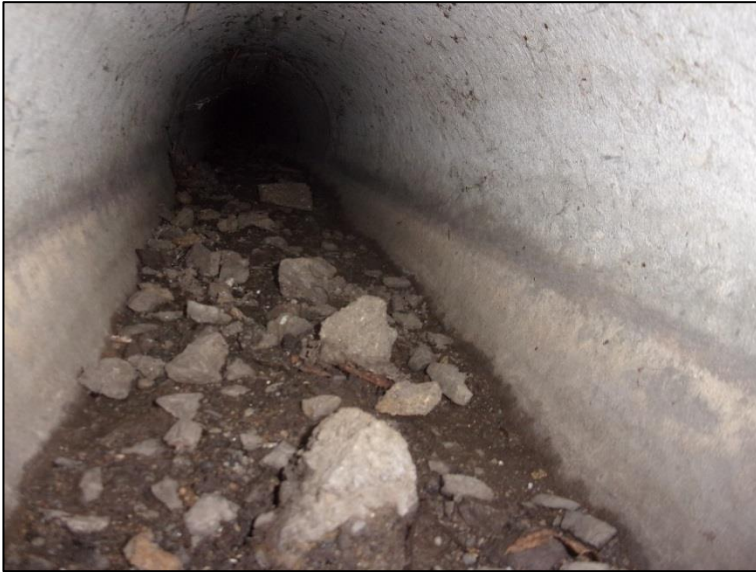
Photo 2 : Vue d'un réseau à curer – Réseau Ø300 de la rue Madame de Sévigné
