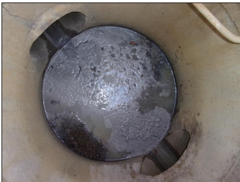
Photo 5 : Vue d'un mauvais rejet
