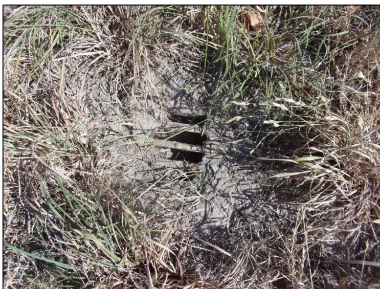
Photo 7 : Avaloir grille à nettoyer – Rue de Vitré
