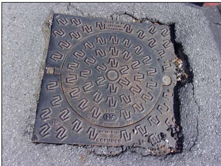
Photo 6 : Tampon à sceller – Salle multisport
