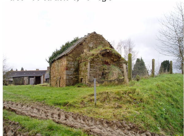
Four à restaurer, le Bourg Neuf
