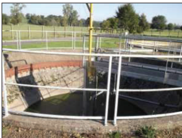
Bassin tampon : 70 m 3
