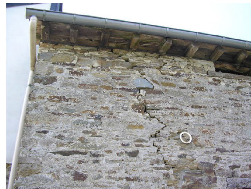
Désordre de façade
