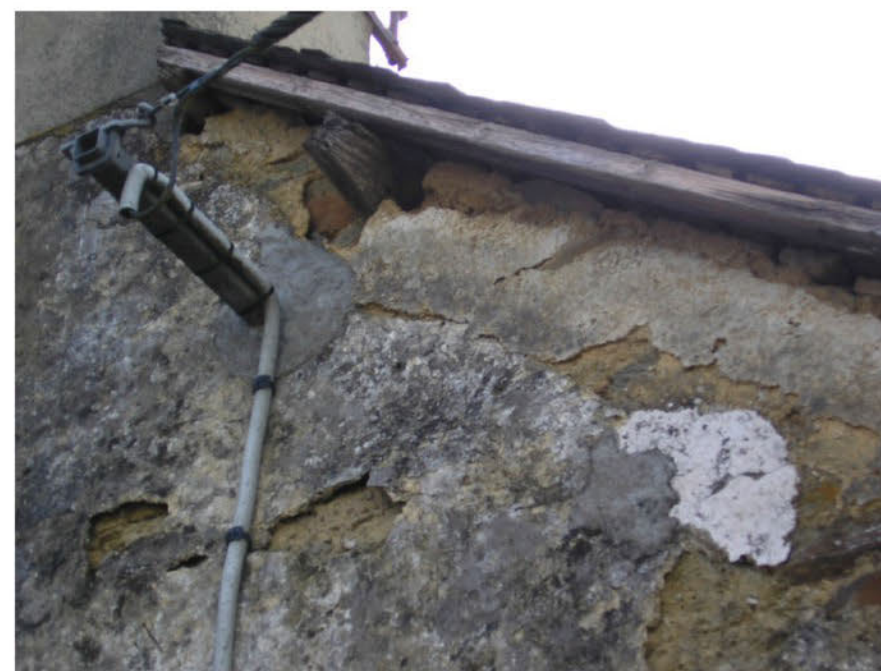
Dégradation du pignon ouest
