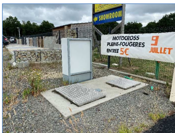
Figure 3 - Poste de relevage des Lavandières
