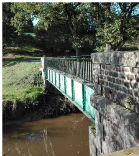
Vue sur le pont sur le Couesnon, au lieu-dit La Loirie, considéré comme un obstacle à l'écoulement du fleuve
