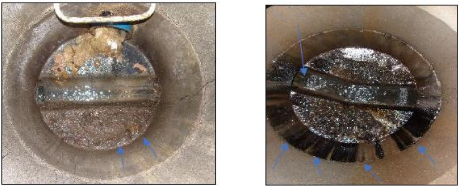
Illustration des défauts observés (RV01 à gauche et RV02 à droite)
