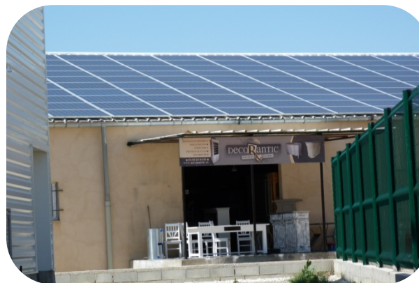
Photographie 4 : exemple de générateur photovoltaïque
