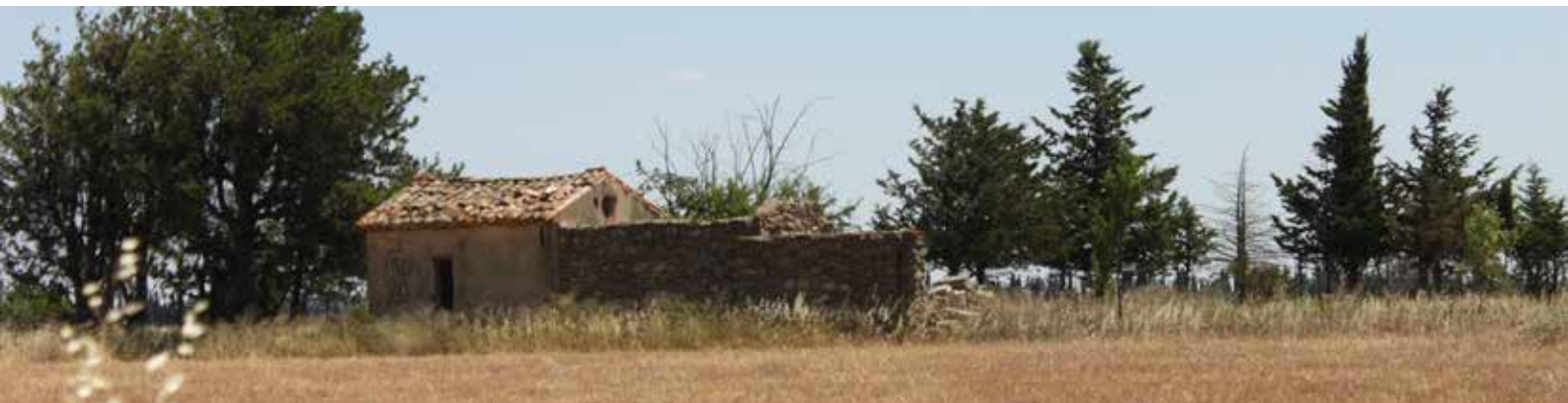
Un mazet en mauvais état au coeur d'une parcelle agricole.
