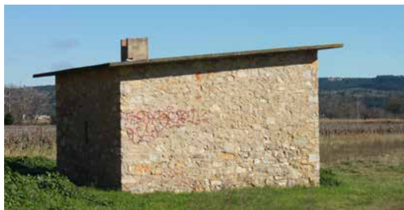
Un mazet dénaturé par sa toiture béton.
