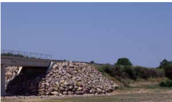
Enrochement incompatible avec le site classé
