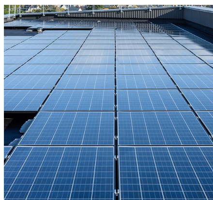
Toiture photovoltaïque avec acrotère
