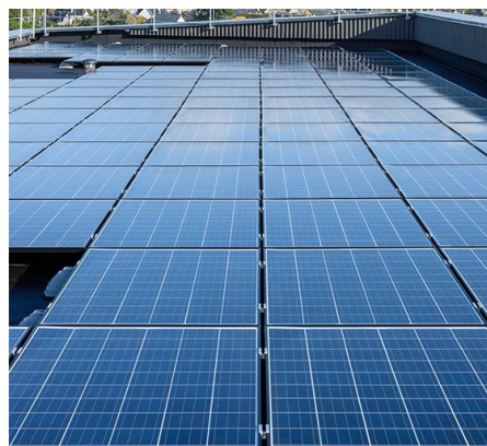
Toiture photovoltaïque avec acrotère
