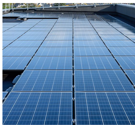
Toiture photovoltaïque avec acrotère
