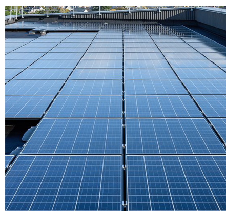
Toiture photovoltaïque avec acrotère
