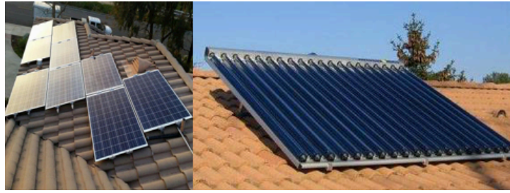
Implantations interdites : implantations anarchiques et/ou en sur-épaisseur décollée de la toiture
