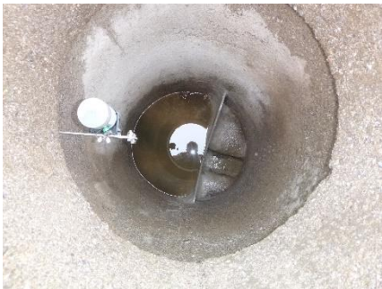
PT_004 Point réseau branche est
