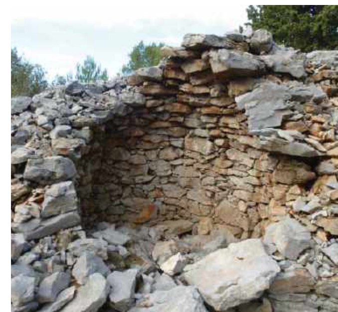
Les capitelles sont un patrimoine essentiellement menacé par l'érosion : peu accessibles, elles sont ainsi relativement préservées et sont par ailleurs bien identifiées comme élément patrimonial.
