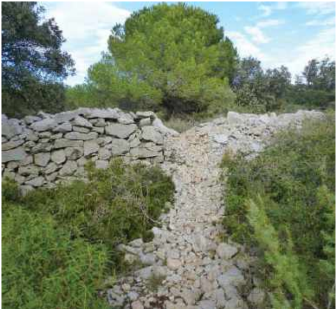
Les passages répétés (chasse, animaux, VTT, trail...) provoquent ponctuellement des dégâts.
