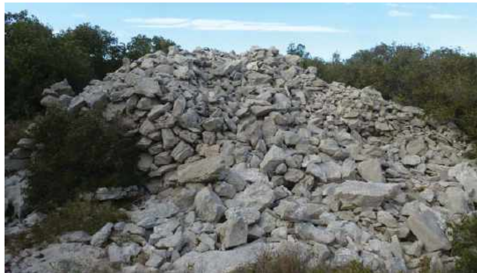
Capitelle effondrée dans le secteur de Petit Pech Monier
