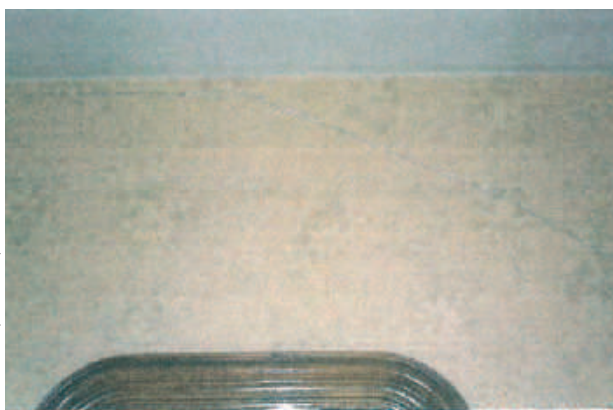
Fissuration intérieure, tapisserie déchirée - Maison André.
