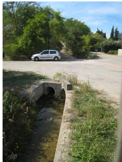
Réseau pluvial avant exutoire dans l'Hérault
