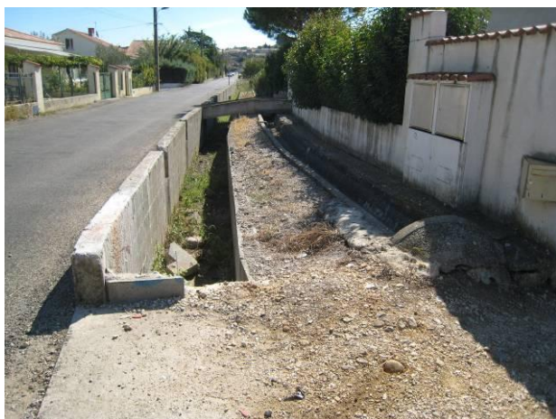
Réseau pluvial sur le chemin de la grande Barque
