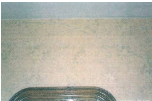
Fissuration intérieure, tapisserie déchirée - Maison André.
