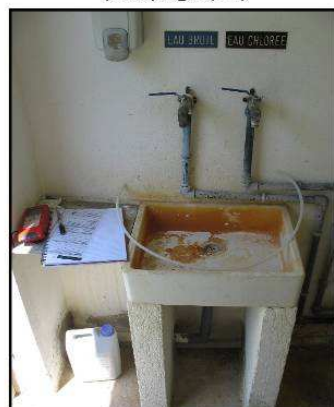
Vue poste prélèvement eau brute / traitée (19)
