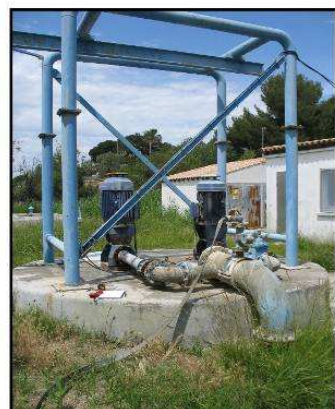
Vue générale du captage et des groupes de pompage (13)
