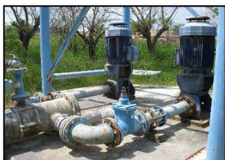
Vue détaillée groupe de pompage (14)
