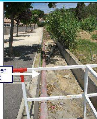
Vue canalette (Nord PPI) avec canalisation EU Utilisation pour le trop plein (3)
