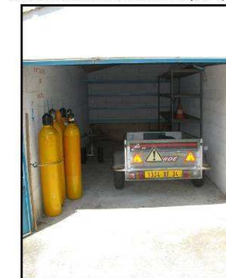
Vue stockage bouteilles de chlore (22)
