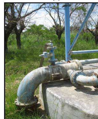
Vue du trop plein utilisé lors de la remontée de la nappe dans la parcelle à proximité (15)
