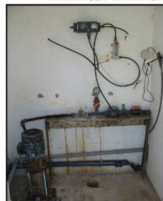
Vue pompe chloration (20)
