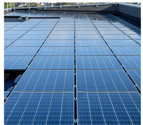
Toiture photovoltaïque avec acrotère
