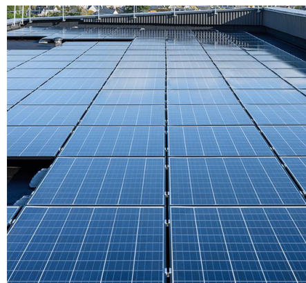
Toiture photovoltaïque avec acrotère
