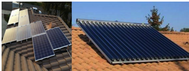
Implantations interdites : implantations anarchiques et/ou en sur-épaisseur décollée de la toiture
