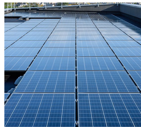
Toiture photovoltaïque avec acrotère
